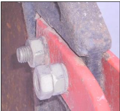
Рис. 3. Розмір контргайки не відповідає розміру основної гайки.
