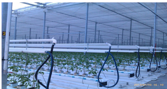
Рис. 3. Обігрівні труби опалювальної системи в теплиці
