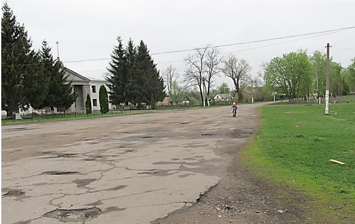
Рис. 1. Ділянка дороги по вул. Івана Франка у с. Малківка (відсутні тротуари, зруйнований дорожній одяг).
