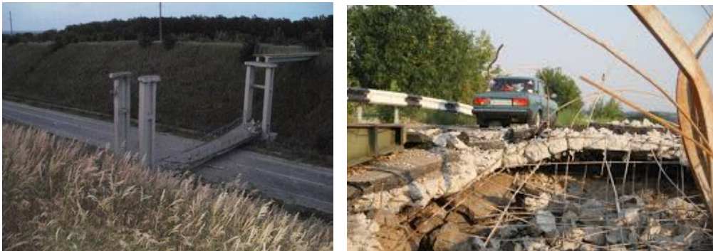
Рис. 3. Пошкоджені автомобільні мости.
