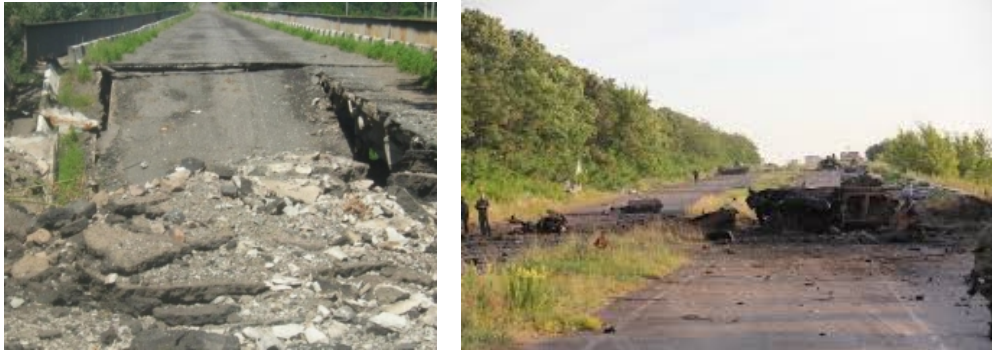
Рис. 2. Пошкоджені автомобільні дороги з асфальтовим асфальто-бетонним покриттями.
