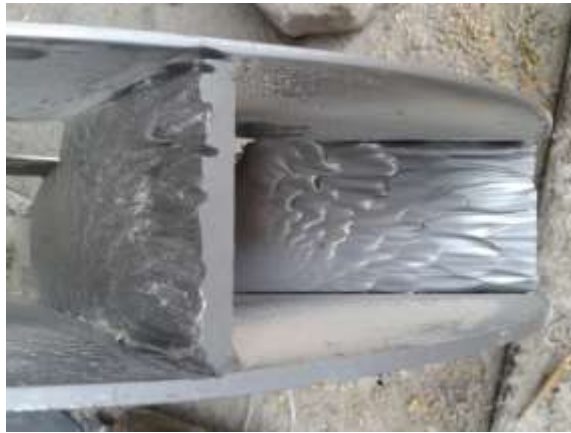
Рис. 1. Зношення колеса вентилятора.
