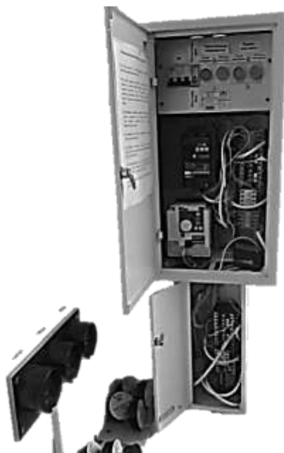
Рис. 8. Зовнішній вигляд електрощита з частотними перетворювачами.
